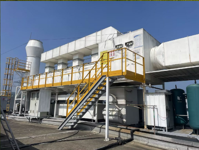
▲ 废气处理设备
